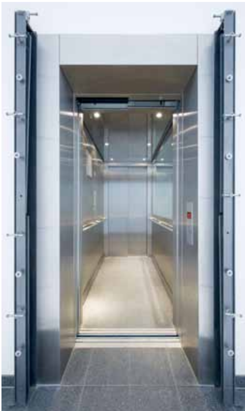
Ansicht Aufzugsanlage Haupthaltestelle mit Hochwasserschutz
