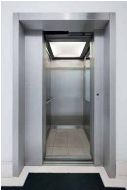
Ansicht Aufzugsanlage Obergeschoss
